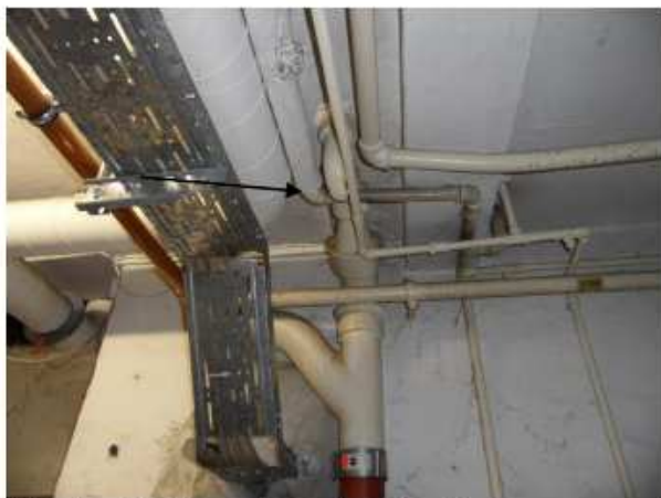
Uisoleret koldtandsrør giver kondens
