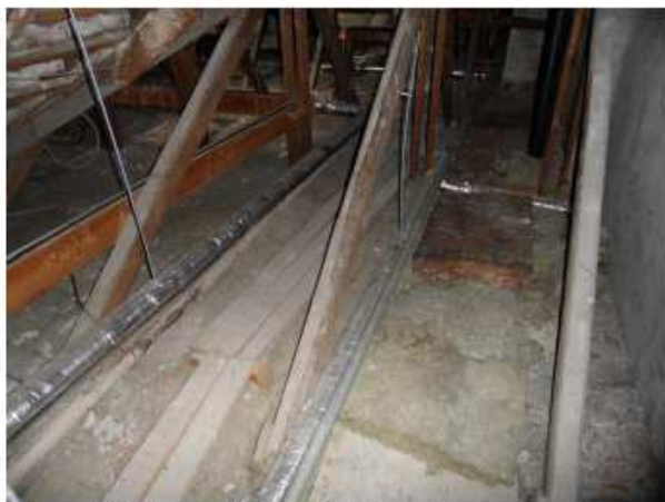
Mangelfuld gangbro nedtrådt isolering
