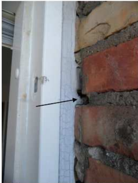
Mulig utæt elastisk fuger ved altandør
