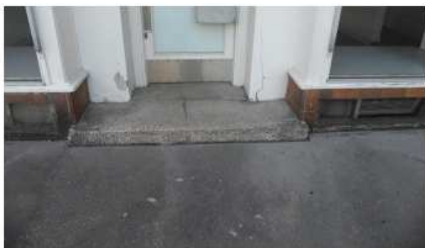
Revner i terazzo og pudsskader ved sokkel.
