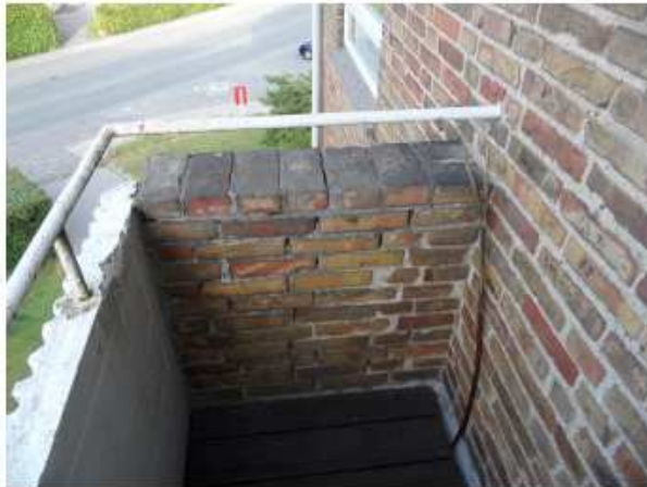
Muret brystning med skader
