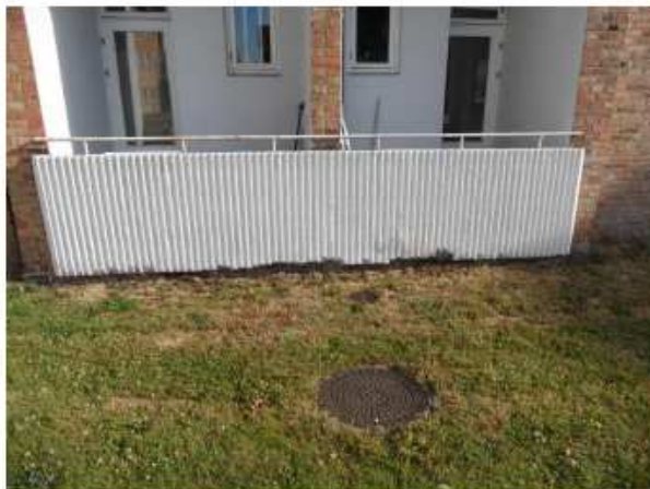
Betonbrystninger med skader
