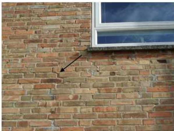
Facade med udvaskede fuger
