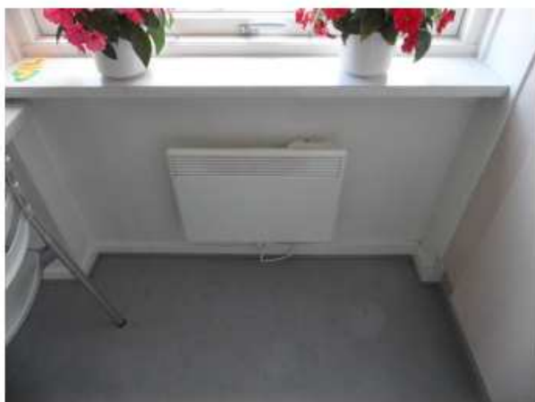
Manglende varme i køkken.
