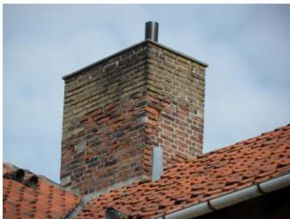
Skorsten med forvitrede sten og udvaskede fuger.
