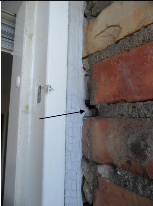
Mulig utæt elastisk fuge ved altandør
