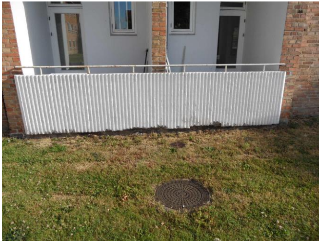
Betonbrystninger med skader
