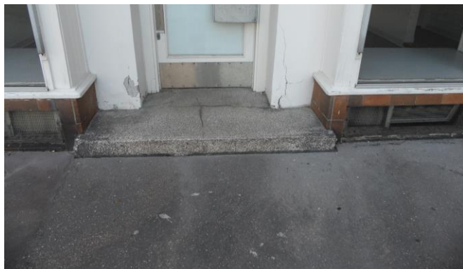
Revner i terazzo og pudsskader ved sokkel.
