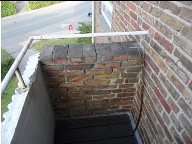
Muret brystning med skader
