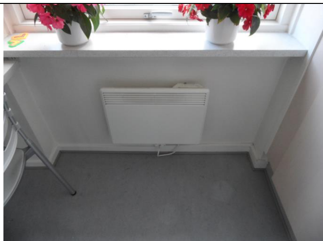
Manglende varme i køkken.
