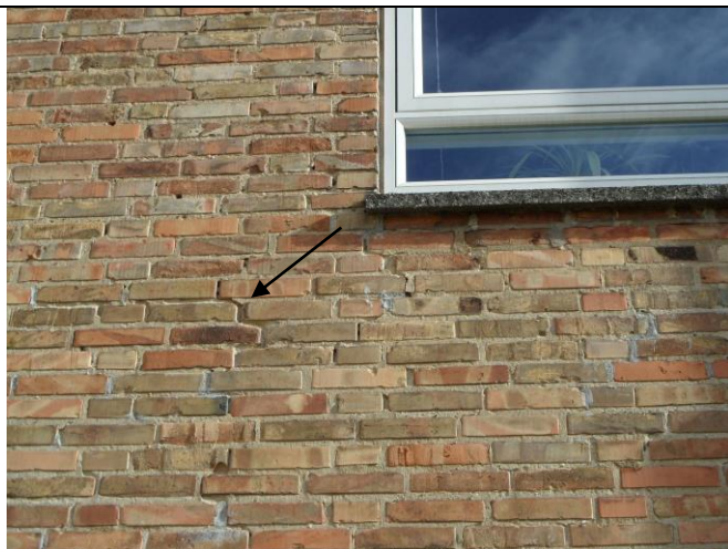
Facade med udvaskede fuger
