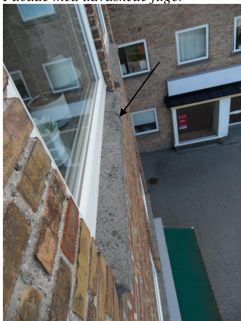
Sålbænk med revner og nedslidt overflade.
