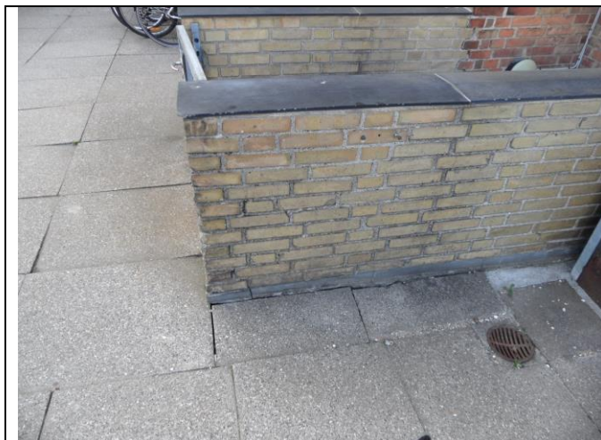
Belægning ligger uroligt
